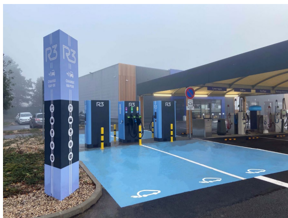
Les bornes 3 x 150Kw du site R3 / Norauto - Faches-Thumesnil (Hauts de France)
